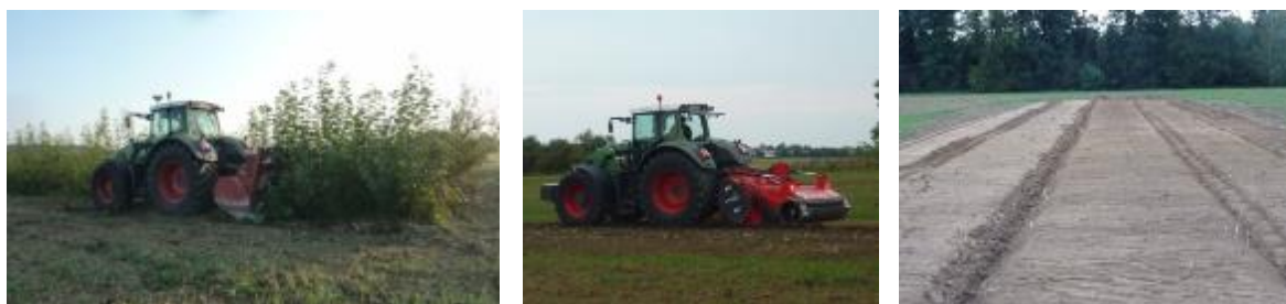
Abbildung 17: Rodung des Energieholzstreifens am Standort Neuhof mit einem Forstmulchgerät (links) und einer Rodungsfräse mit Rückverdichtung (Mitte) zur Wiederherstellung einer ackerfähigen Fläche (rechts)
