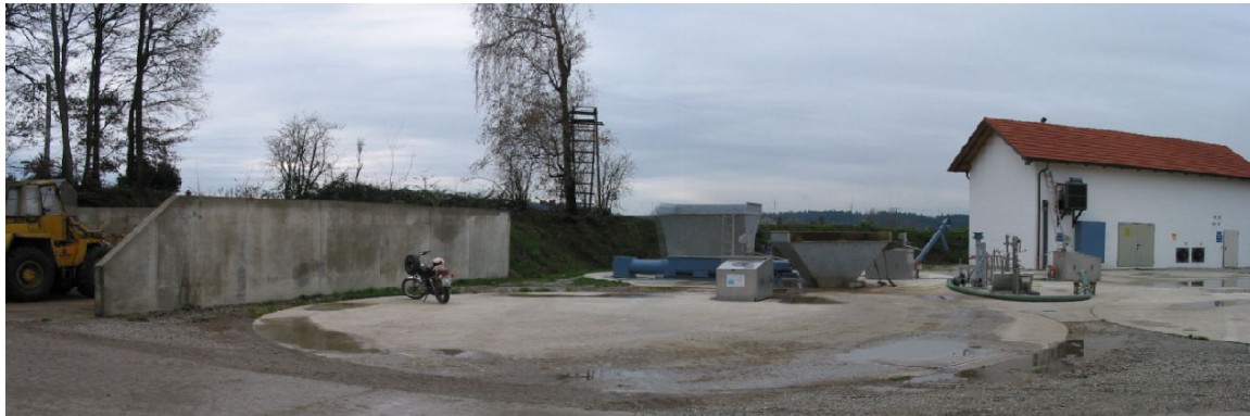
2-stufige Biogasanlage mit Einspülschacht, Feststoffeinbringung, Serviceschacht und Maschinenraum
