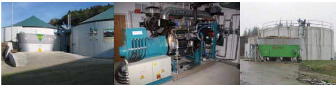
Bilder von bayerischen Pilot-Biogasanlagen (von links nach rechts); Parallel-Fermenter mit Feststoffeintrag; Zündstrahl-BHKW; Hochlastfermenter einer einstufigen Anlage
